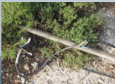
Autentický stav rozvodu elektřiny na ostrově
